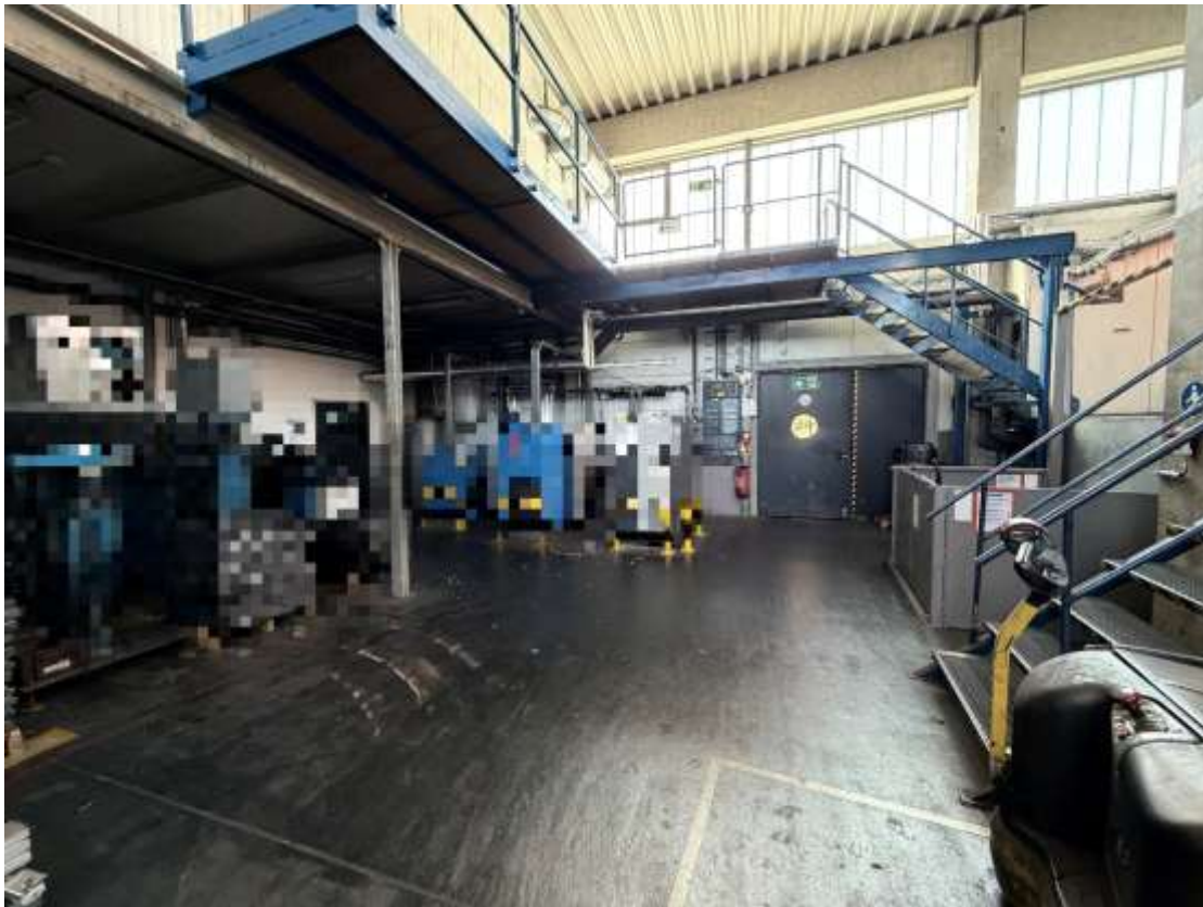
Foto 20: H5 Kompressoren und Logistik
