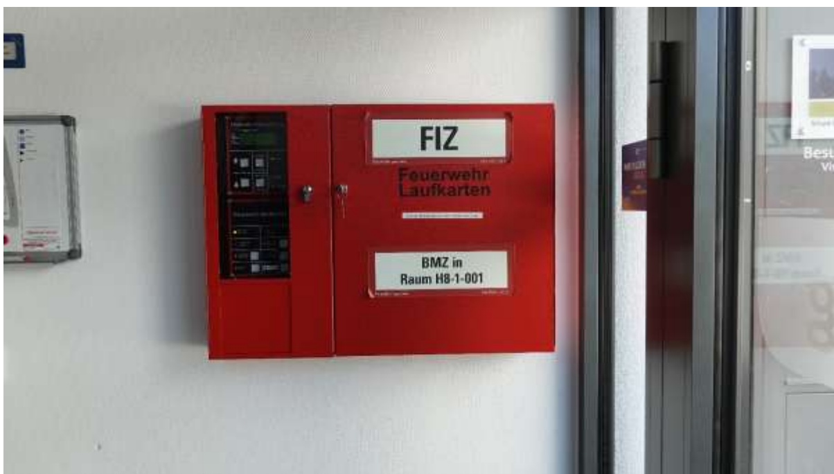
Foto 49: H8EG Teil der Brandmeldeanlage im Eingangsbereich
