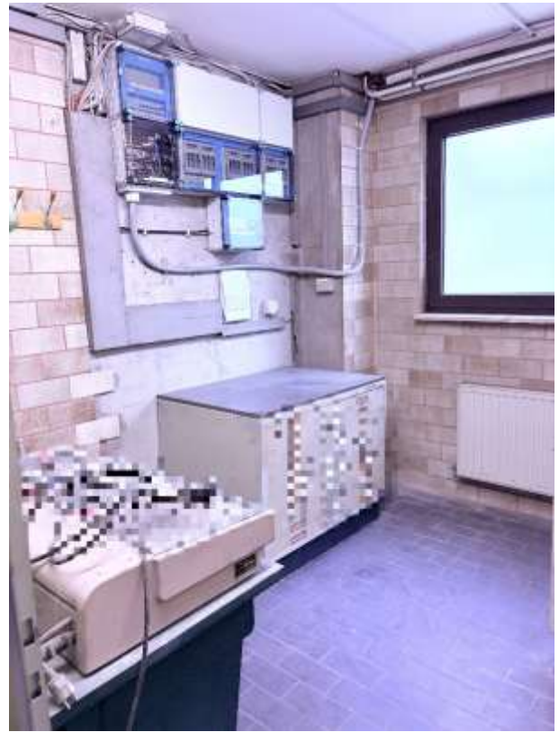
Foto 23: H6KG Lager und Stromverteiler
